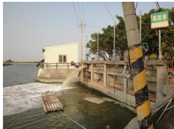
24 號水門升降及抽水機排水操作實況
